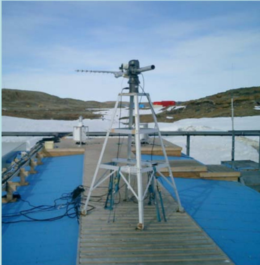
観測棟屋上 データ受信アンテナ
